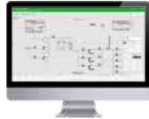
AVEVA™ System Platform AVEVA™ Plant SCADA
